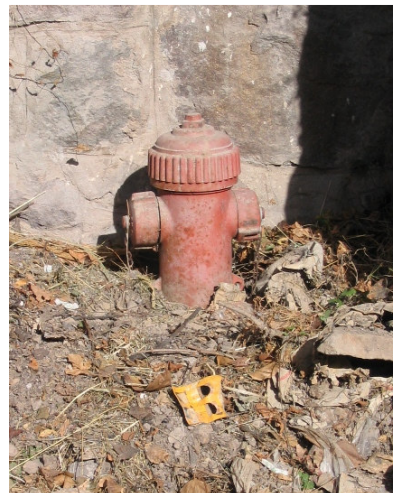
Fig. 3 – Idrante a colonna ostruito da materiale depositato.
